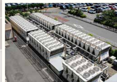
電気式空冷ヒートポンプチャラー
